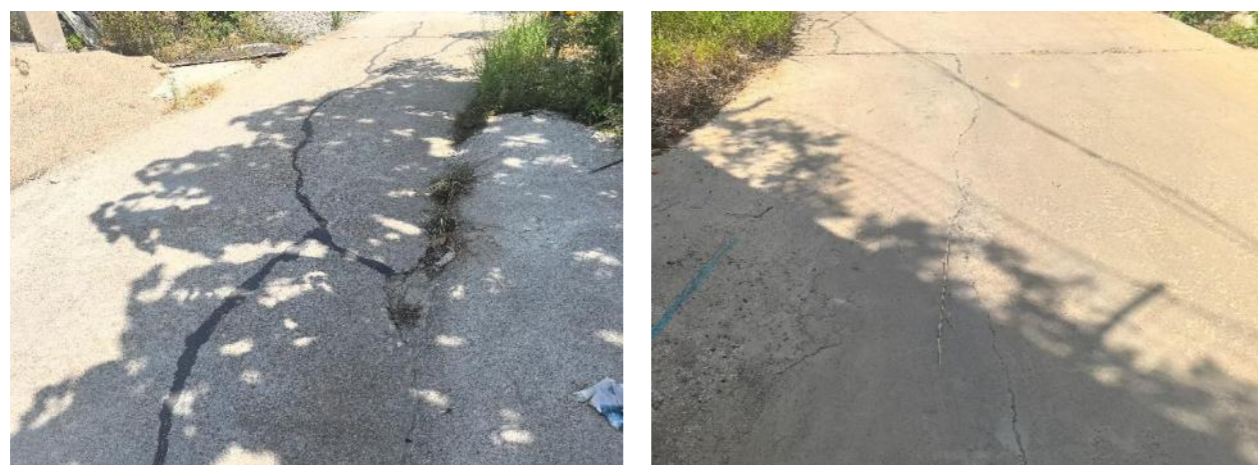
图 5-1 水泥路面现场病害图
