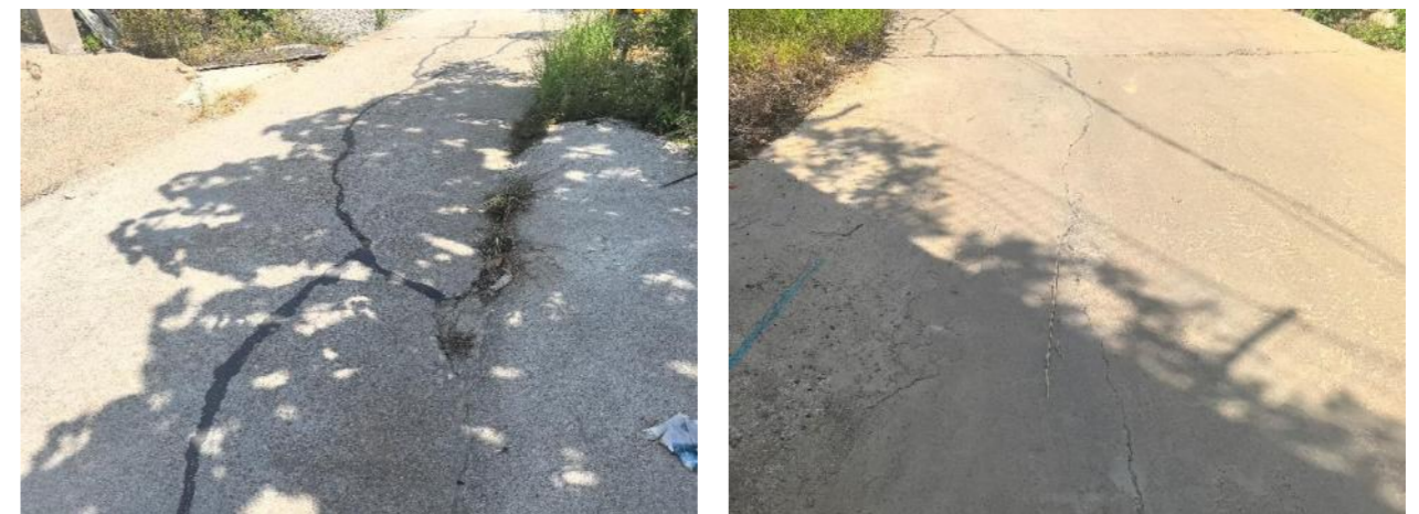
图 4-1 水泥路面现场病害图
